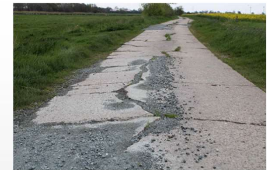
Stark geschädigter Betonplattenweg im Landkreis Cuxhaven
